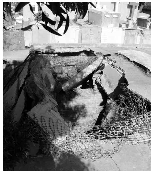
Imagen 5. Socavón en la parte oriente del Cementerio N°2. Propiedad de la Autora, 2020.
