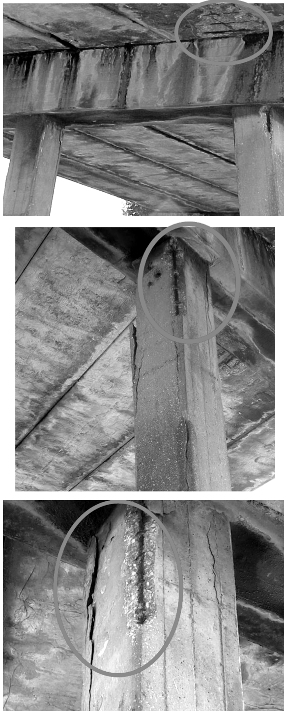
Figura 2. Elementos con desprendimiento de concreto, acero expuesto y agrietamiento
