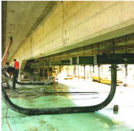
Fig. 11.- Inyección de Hormigón Autocompactante por la base del encofrado en vigas de puentes.
